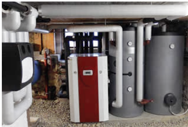
Für den Ersatz einer fossilen Heizung durch eine Sole-Wärmepumpe (Bild) spricht der Kanton Fördergelder.
